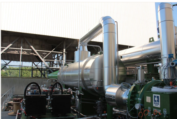
PAC 3700 kW, condensation de vapeur BP, UVE Le Mans
