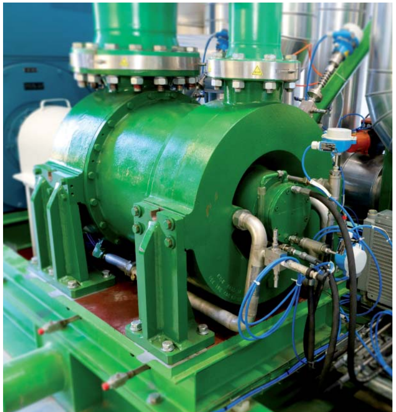
Beispiel einer ORC-Turbine
